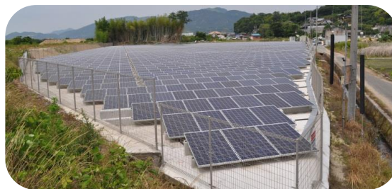
自社敷地に設置した太陽光発電
