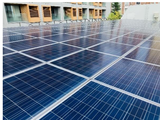
《併設する建物屋上に設置されたソーラーパネル》
