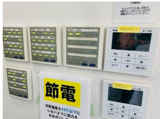
《客室ごとの個別空調システムを採用》
